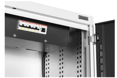
Caja de fusibles FI
